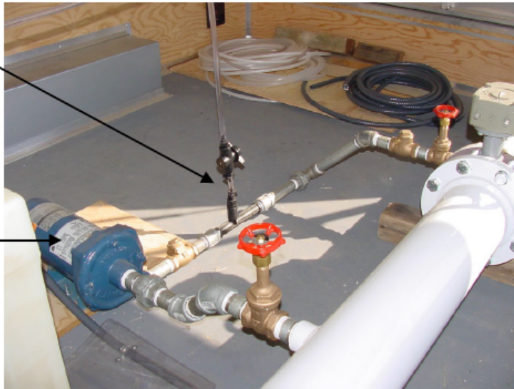
Figura 7. Venturi instalado en configuración de bypass
